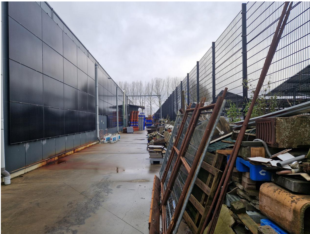
Foto 10: zonnepanelen op de zuidgevel van het bedrijfsgebouw.
