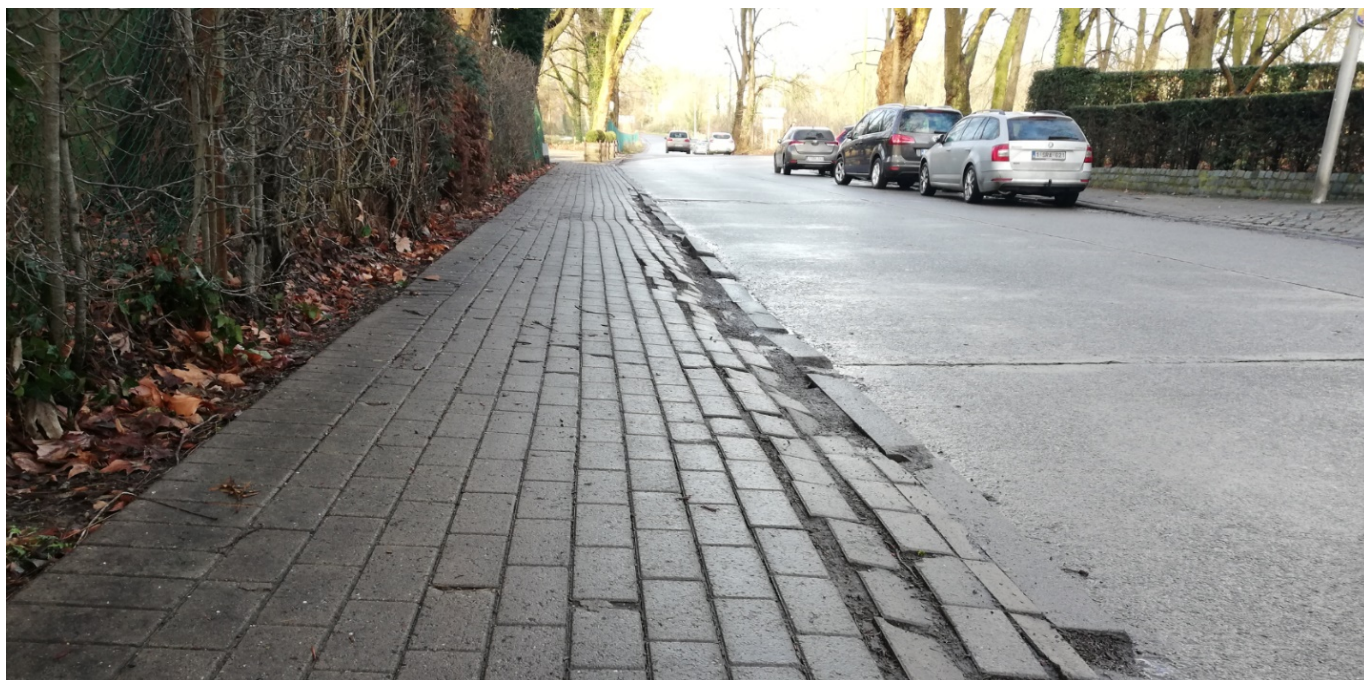
Figuur 27: Beschadigde bestrating door passerend zwaar verkeer buiten de rijbaan (Is. van Beverenstraat).
